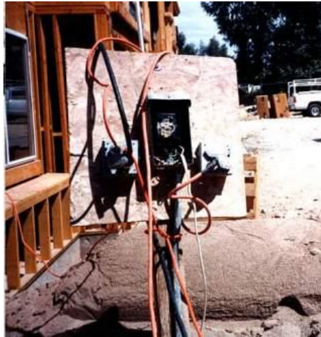
Gambar 16 penggunaan peralatan listrik yang tidak aman
