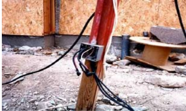
Gambar 10 Kondisi peralatan yang perlu diberikan penutup yang memadai
