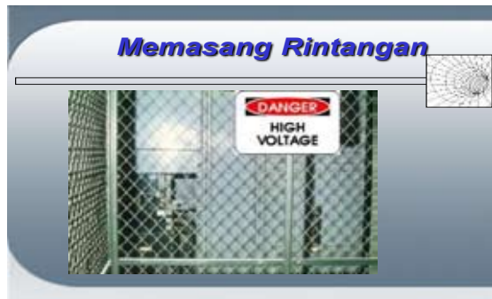
Gambar 4 Peralatan yang mempunyai tegangan tinggi harus dibuat rintangan untuk mencegah terkena arus kejut
